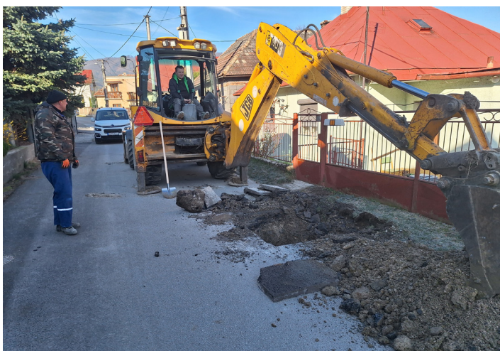
Ani tento rok sa nám nevyhli poruchy a následné opravy na obecnom vodovode v Babkove.
